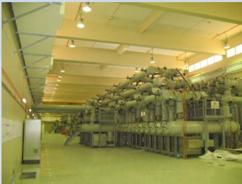
Faza VIII Trafostanica Umm Al Amad Super SS
